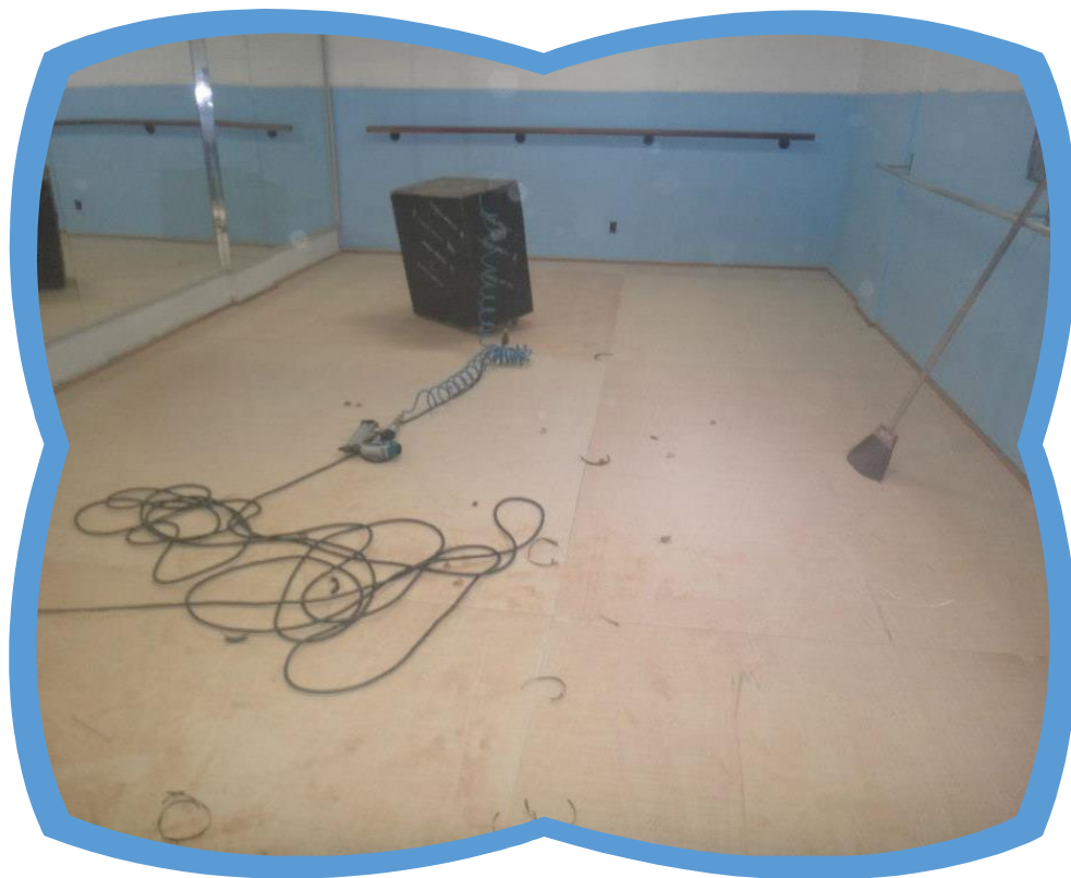
Antes da Instalação do Piso da sala de dança Profissional do Primeiro Andar
